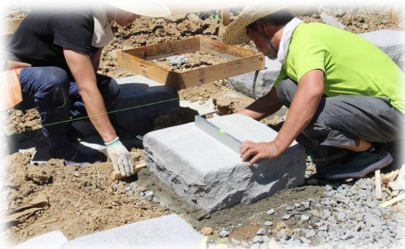
置いた石が水平に置けているかを水平器で確認しています。
